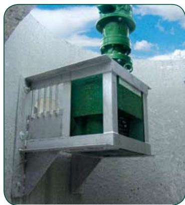
Mini Monster installé à l'entrée d'une station de pompage
