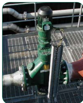
Muffin Monster installé en ligne
