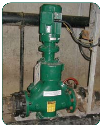
Muffin Monster installé en ligne
