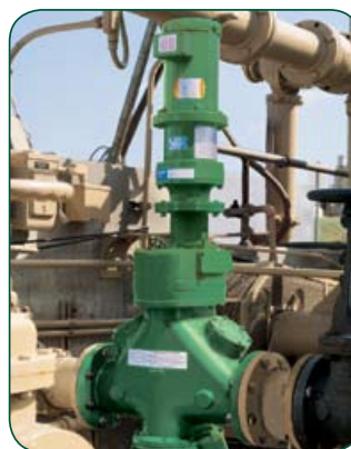
Muffin Monster installé en ligne
