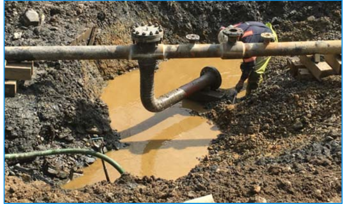
Excavation remplie d'eau boueuse
